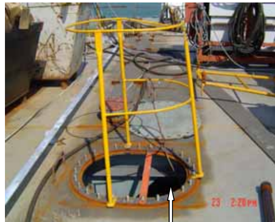
ダクト引き込み側
