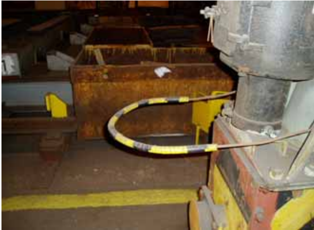
(クレーン足元ガード)
