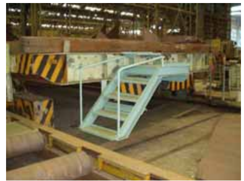
(台車昇降設備)
