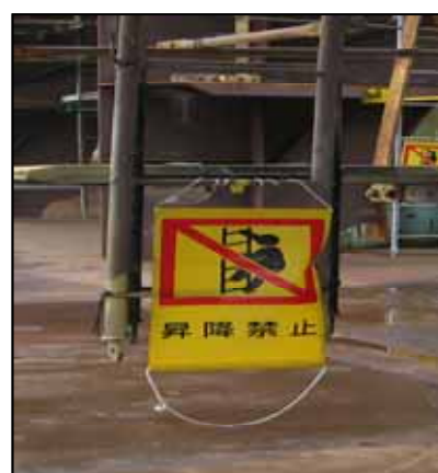
(仮設足場用「昇降禁止」表示)
