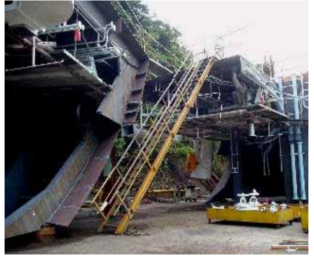
(安全作業昇降階段)
