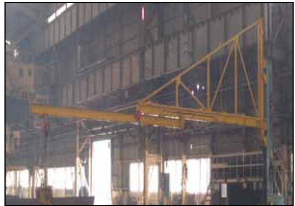
定盤の足元のケーブルをなくす。 (CO2溶接機供給装置のハンドリガ伸縮ブーム)
