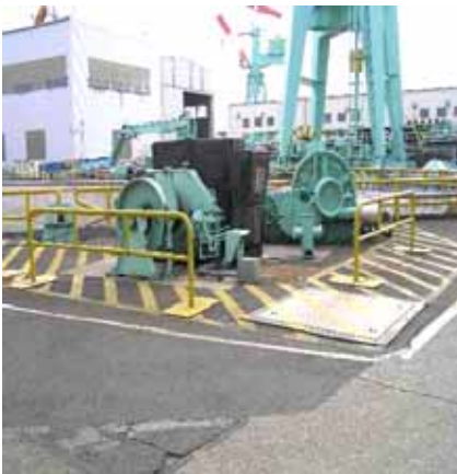
(クレーン足元ガード)
