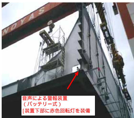
(クレーン走行時の警報装置)
