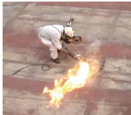
②高圧ホースの被覆の剥れた部分に溶接棒が接触すると、瞬時に炎が走る。
