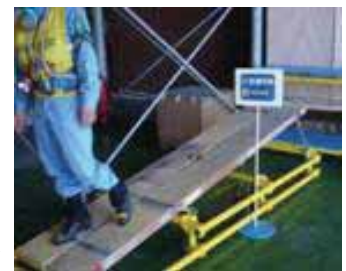
⑤ 足場天秤体感 (未固縛足場)
